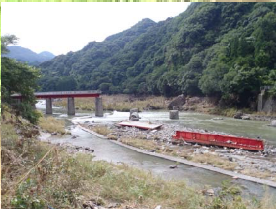
写真 20 橋げたが流された人道橋
