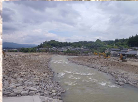
写真 14 破堤し、新たに仮築堤した左岸堤防
