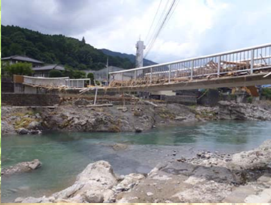
写真15 橋に木材が乗り上げた痕跡
