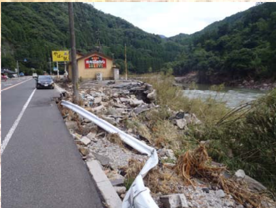
写真16 川沿いの道路の被害
