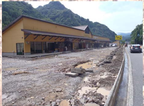
写真18 被災した物産店街 (店の裏側は川)
