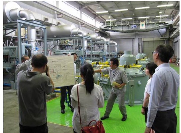
排水機（ポンプ）の紹介
