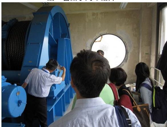
水門操作室の説明
