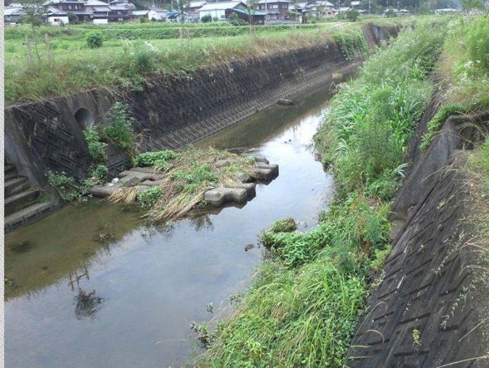
根固めブロックの放置
