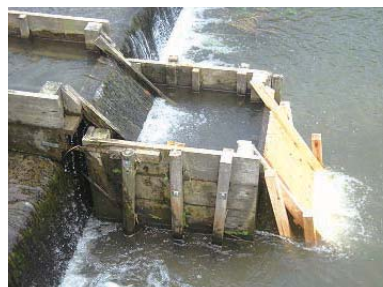
【最下段の吐口が流下方向にまっすぐになっている(改良後)】
