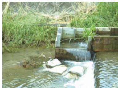
【最下段の吐口が流下方向に対して直角に向いている(改良前)】
